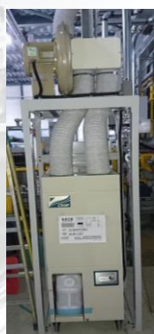
カメラユニット冷却用 スポットクーラー
